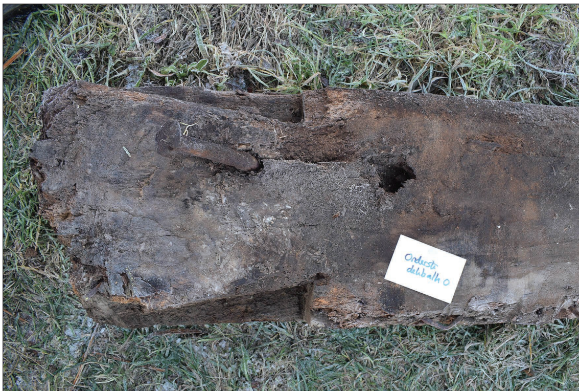
Afb. 47. Voorloef in de oostelijke dekbalk.
