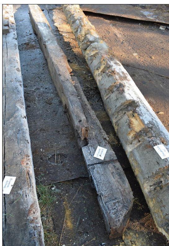
Afb. 44. In het midden de westelijke dekbalk, met aan de onderzijde het verlengstuk van naaldhout. De schuine las is duidelijk zichtbaar.
