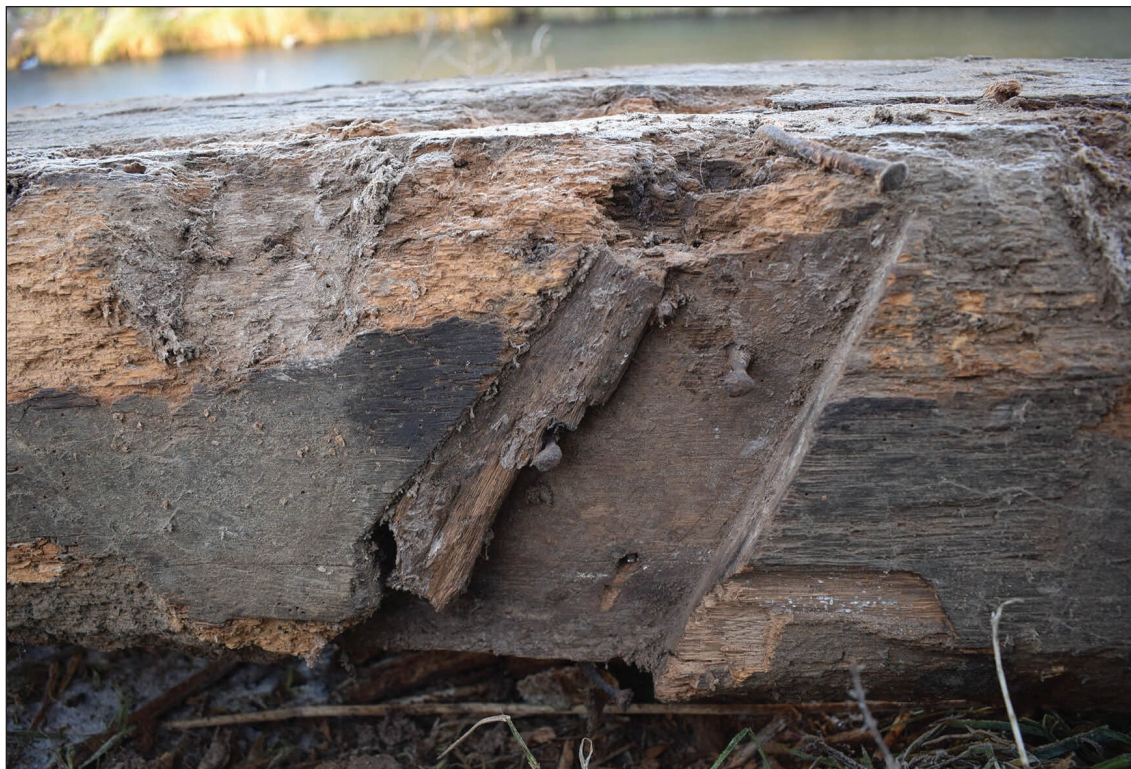
Afb. 53. Inkeping voor lipverbinding met hak op de oostelijke dekbalk, na de sloop.
