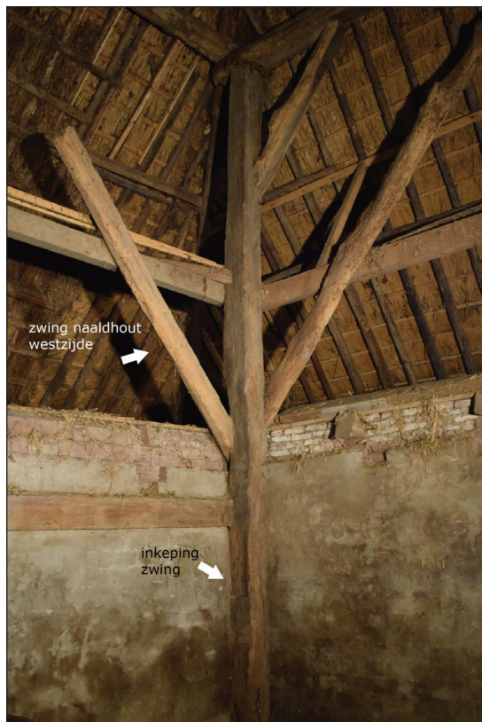
Afb. 60. Zwingen tegen de noordwestelijke stijl, evenals een inkeping van een verdwenen zwing.
