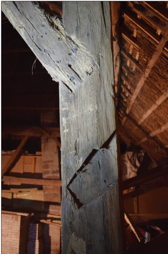
Afb. 43. Een inkeping voor een zwing in de noordwestelijke stijl, horende bij de primaire functie van de balk.
