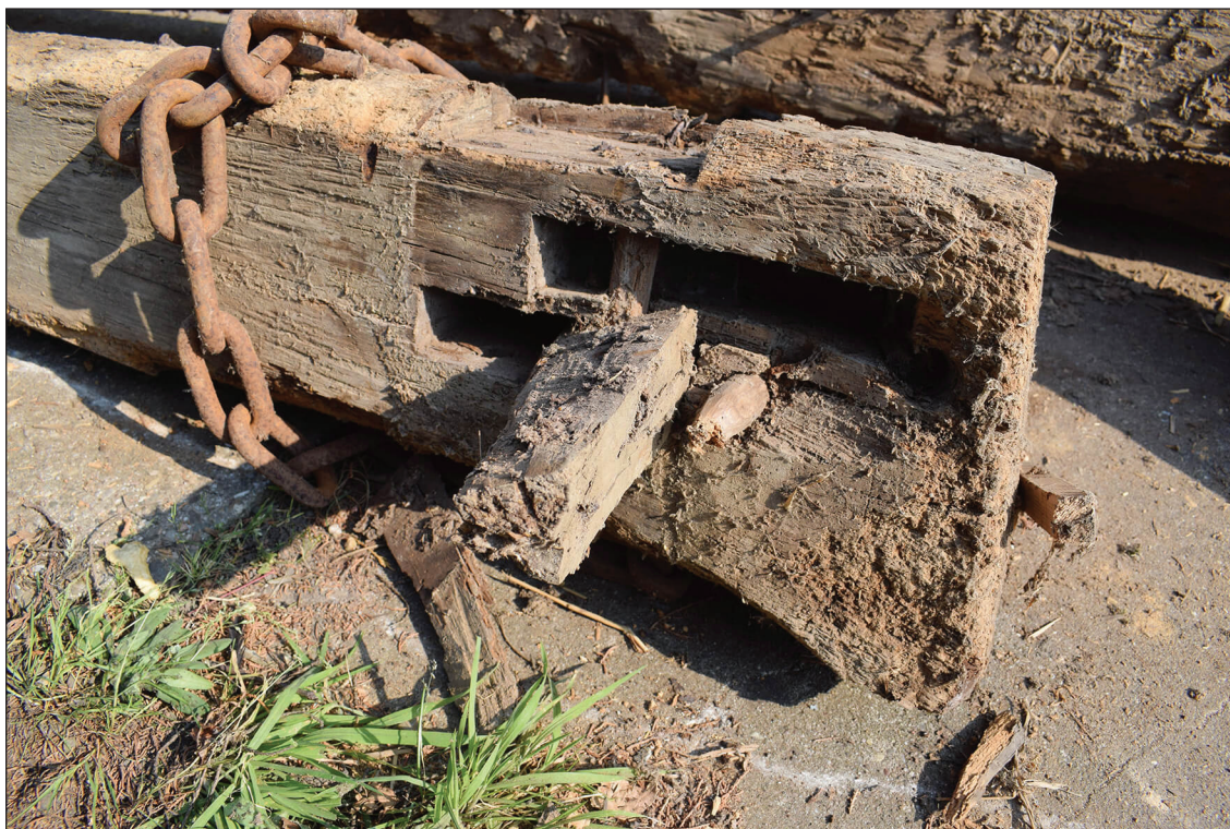
Afb. 36. Pengaten onderin de westkop van de noordelijke dekbalk. Het ene pengat hoort bij het onderzochte vierkant, het andere pengat hoort bij de primaire functie van de balk.
