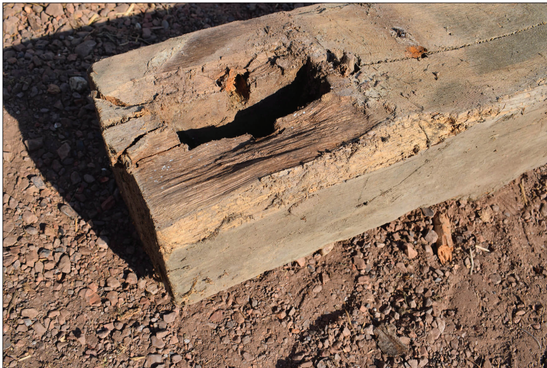
Afb. 35. Pengat onderin de oostkop van de zuidelijke dekbalk.
