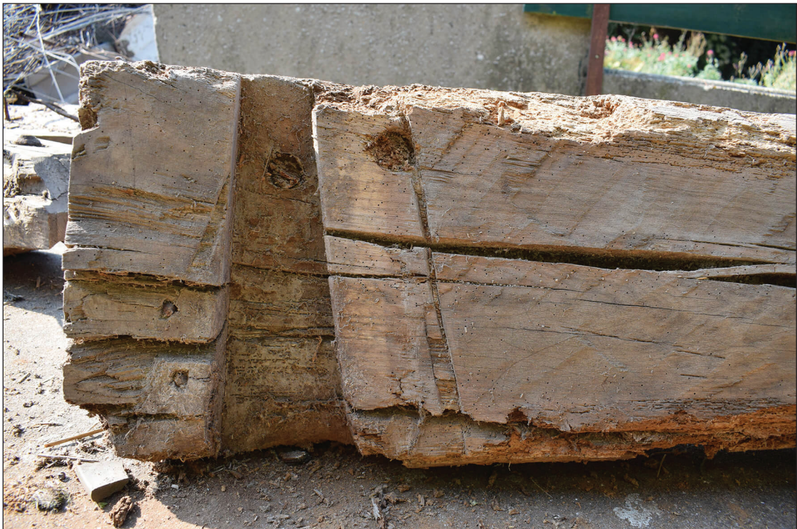
Afb. 41. Loef in de onderzijde van de zuidkop van de westelijke bovenbalk. Hierin bevindt zich een verbindingspen van naaldhout. Rechts daarvan is een verbindingspen van eikenhout aanwezig die hoort bij de primaire functie van de balk.
