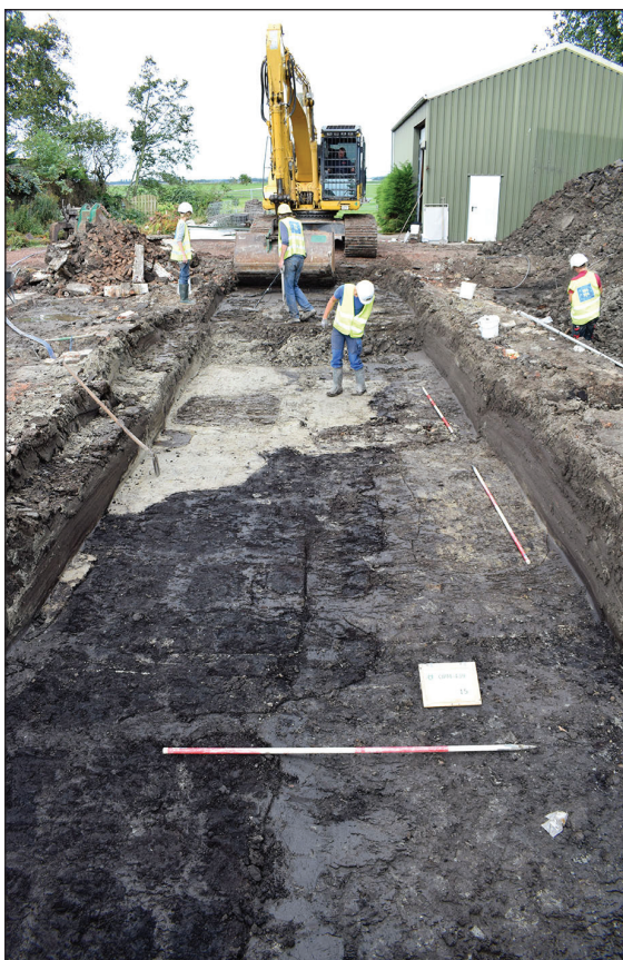
Afb. 63. Werk in uitvoering. Tijdens het verdiepen van het middelste vak kwam onder de laatmiddeleeuwse ophogingspakketten een restveen tevoorschijn (links). Let op de met klei gevulde krimpscheuren.
