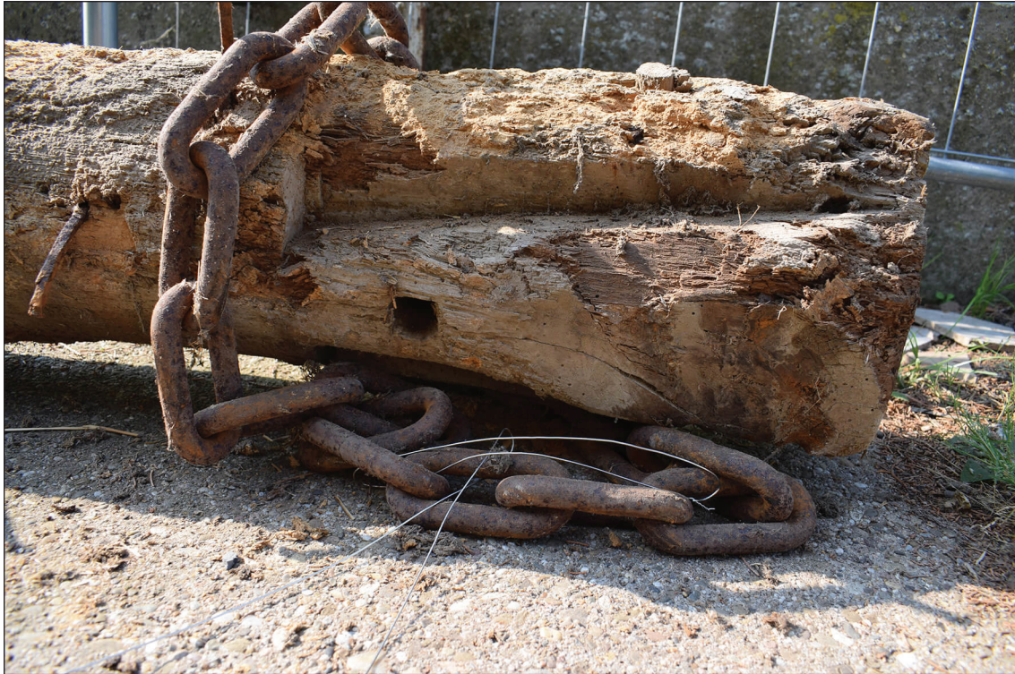
Afb. 38. Voorloef in de bovenzijde van de oostkop van de noordelijke dekbalk. Hierin bevindt zich het ronde gat van een verbindingspen.
