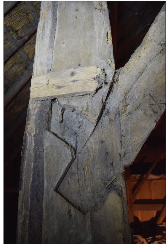
Afb. 44. Rechts een inkeping voor een zwing in de noordoostelijke stijl, horende bij het onderzochte vierkant. De zwing staat tegen de inkeping aan, in plaats van dat deze erin is aangebracht. Links een inkeping voor een zwing die hoort bij de primaire functie van de balk.
