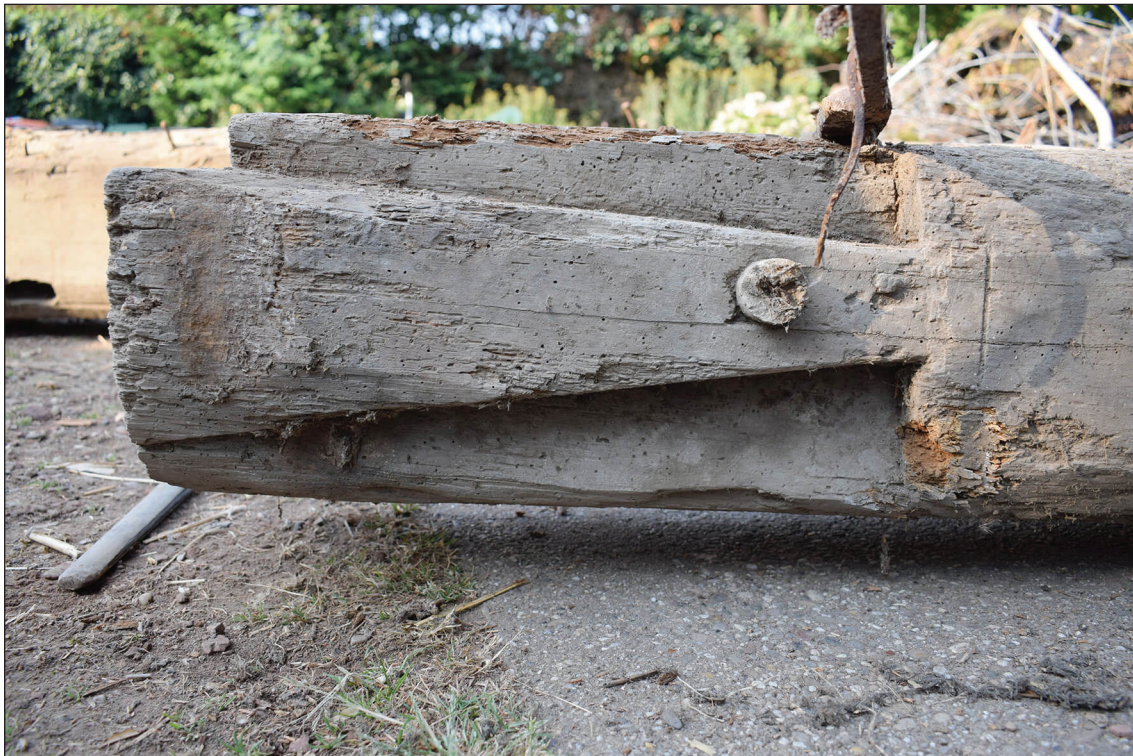
Afb. 39. Voorloef in de bovenzijde van de westkop van de zuidelijke dekbalk. Hierin bevindt zich een verbindingspen van naaldhout.
