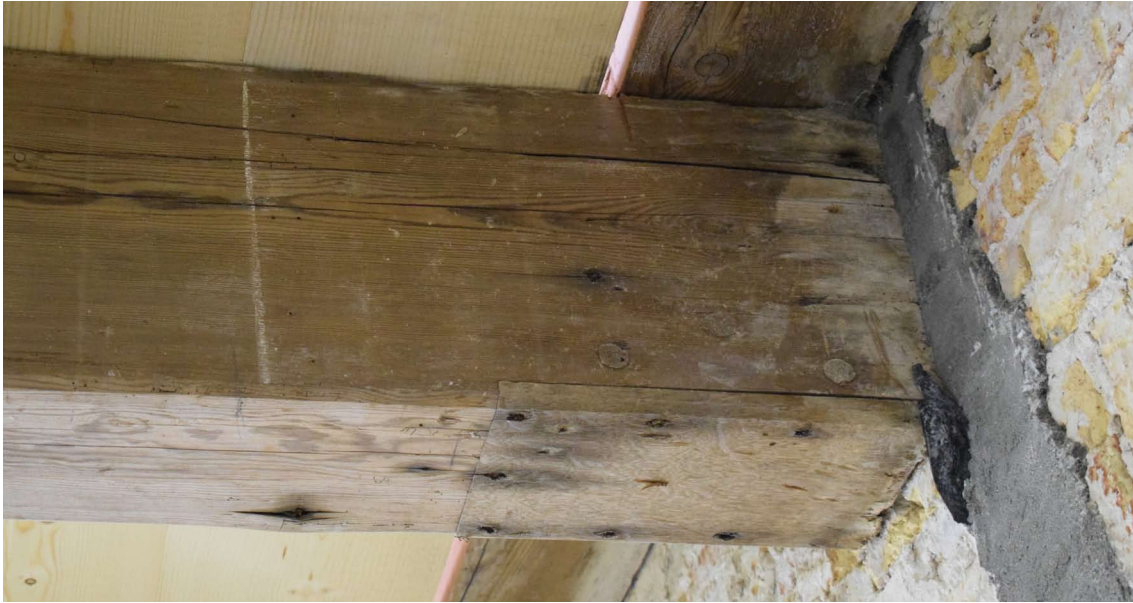
Afb. 41 Dichtgezet pengat met drie toognagels in de vierde balk vanaf de voorgevel.
