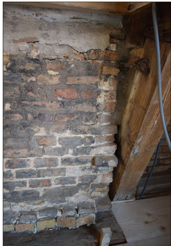
Afb. 53 Weggebroken halfsteens muur aan de noordzijde van de eestmuur.
