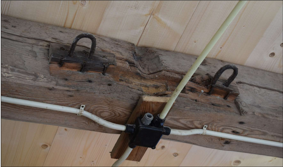
Afb. 48 Inkepingen en ijzeren ogen in de negende balk vanaf de voorgevel, horende bij de bevestiging van de spil van de rosmolen.
