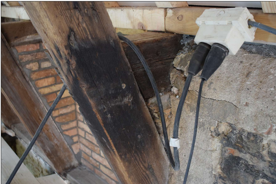
Afb. 55 Beroet deel van het houtskelet op de zolder, als gevolg van de rook uit de eest.
