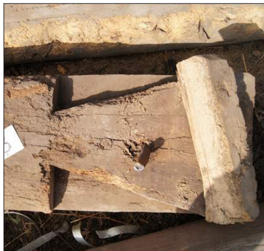
Afb. 99. Voorloef op de bovenkant van de westelijke kop van de dekbalk aan de noordkant. Er is zowel een houten pen als een ijzeren spiebout aanwezig.
