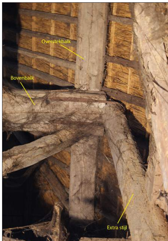
Afb. 96. De extra stijl is verbonden met de bovenbalk door middel van een ijzeren band.
