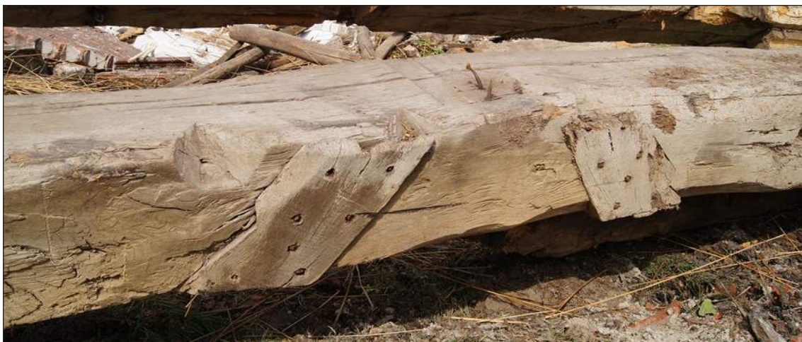
Afb. 104. Afgezaagde zwingen op de noordelijke dekbalk.
