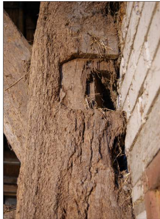
Afb. 106. Inkeping van een verdwenen draagbalk op de zuidoostelijke stijl.
