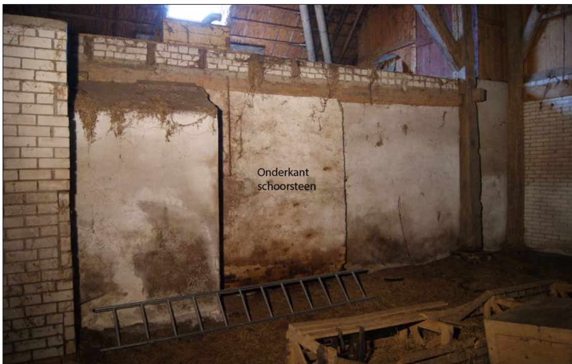
Afb. 75. Bakstenen onderkant van een rookkanaal, gezien vanuit de hooiberg. Erboven bevindt zich de draagbalk.
