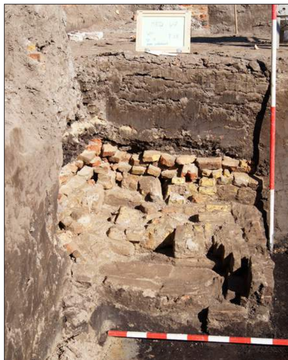
Afb. 117. Onderin in de twee westelijke vierkantspoeren kwamen resten van een afgebroken waterkelder tevoorschijn die als basis dienden voor de fundering. Hier de onderzijde van de noordwestelijke vierkantspoer, S15.
