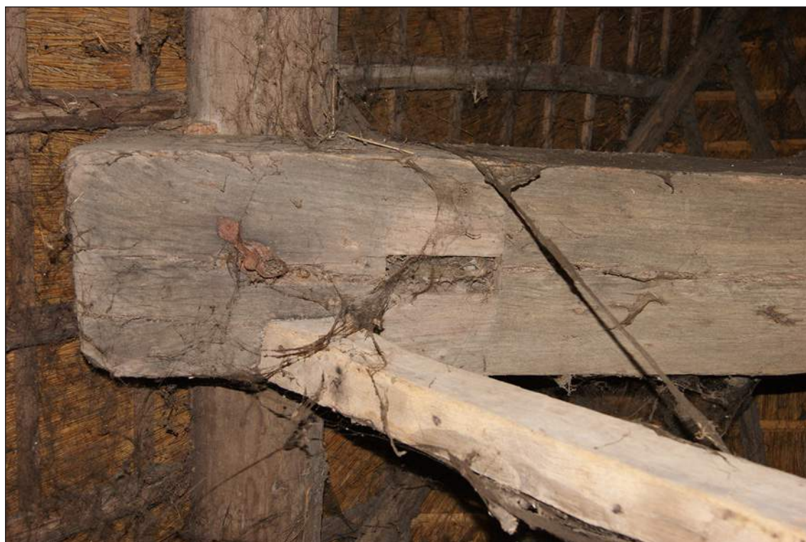
Afb. 89. Onderkant van de westkop van de noordelijke dekbalk. Het pengat hoort bij de primaire functie van de balk.
