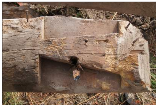
Afb. 97. Voorloef in de oostelijke bovenbalk met ijzeren spiebout.
