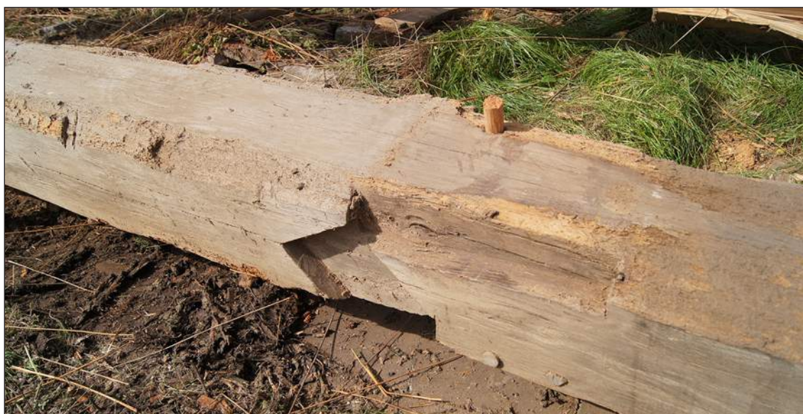
Afb. 90. Schuine inkeping voor een zwing in de noordkant van de noordelijke dekbalk. De inkeping hoort bij de primaire functie van de balk.
