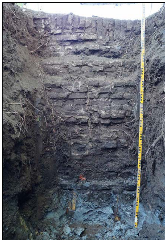
Afb. 44 Achterzijde (landzijde) van de kademuur.
