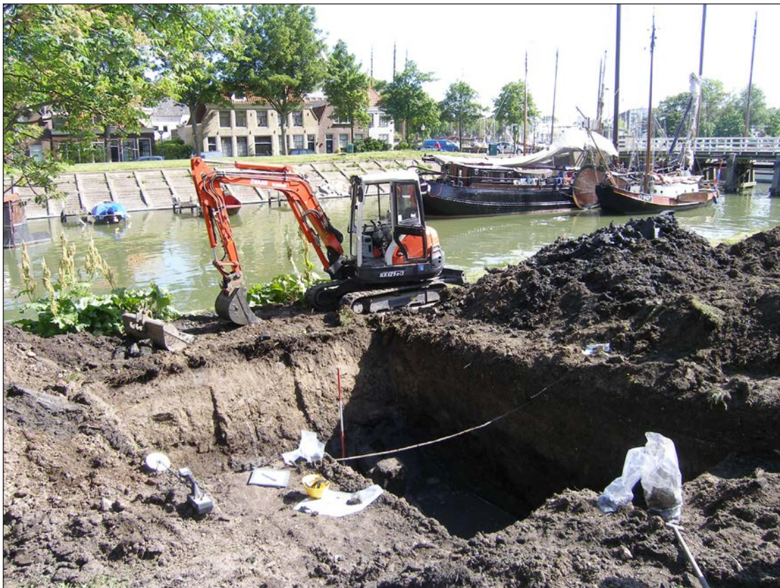
46. Werkput 1 aan de noordzijde van het Oostereiland. Op de achtergrond de bebouwing van het Achter op t Zand. Geheel rechts de brug die het Oostereiland met het Hoofd verbindt.
